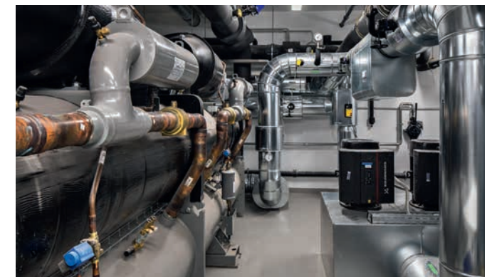
Kältezentrale-Kältemaschine ca. 1,2 MW
